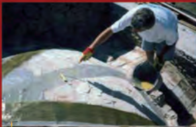
CHIESA SAN CASCIANO IN MODIGLIANA (Faenza) RINFORZO DELLE VOLTE IN LATERIZIO CON MATERIALI COMPOSITI-FIBRE DI CARBONIO Consolidamento statico e risanamento delle volte in laterizio
