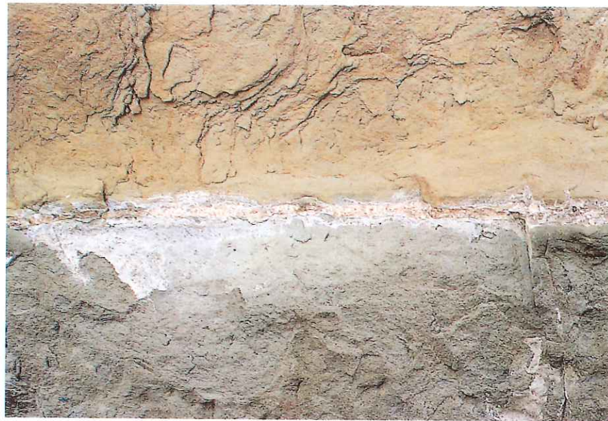
Fig. 10 Esfoliazione su arenaria di Sarnico. È visibile, frai due elementi lapidei, la antica malta di allettamento rosata a base di calce e cocchiopesto
