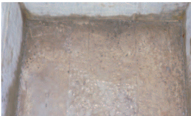
1 VASCA IN CALCESTRUZZO INTERRATA CON VENUTE D'ACQUA PER PRESSIONE DI FALDA
